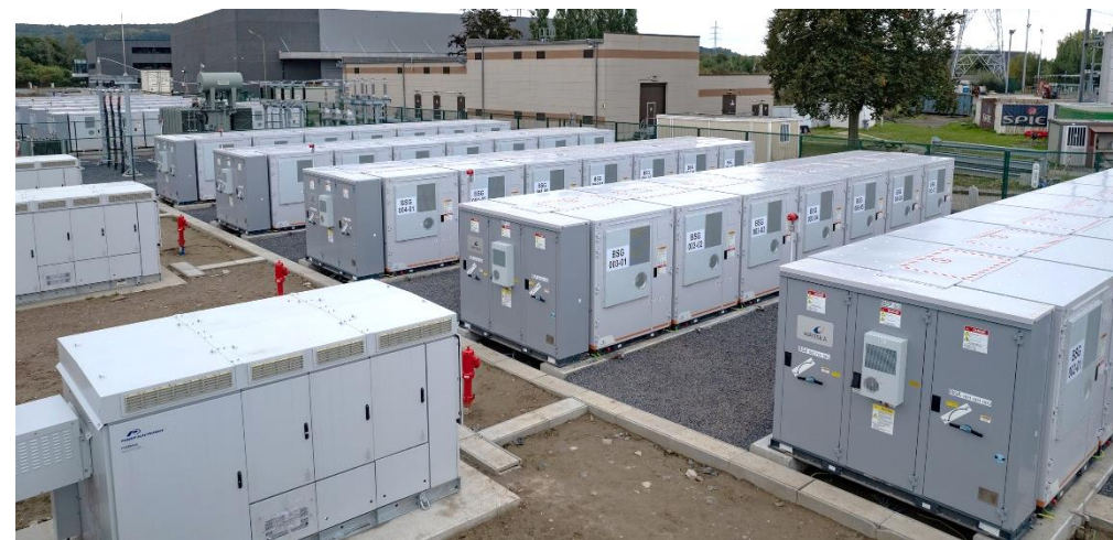
ベルギー-Ruilen蓄電所
