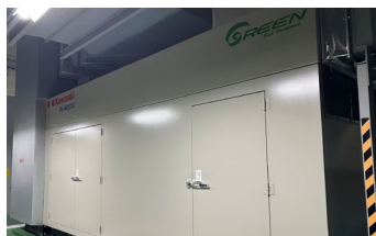
非常用発電装置
