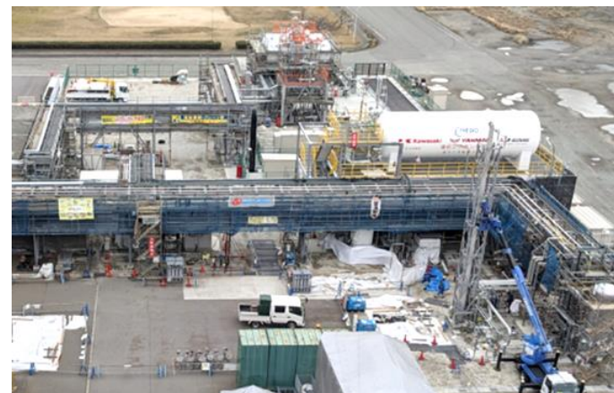
アンモニア・水素燃料供給設備
