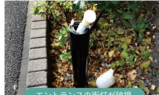
エントランスの街灯が破損
