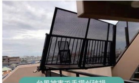
台風被害で手摺が破損
