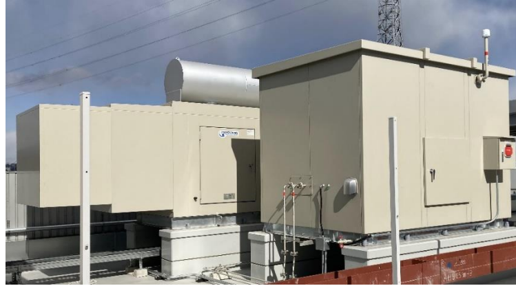
▲ 非常用自家発電システム
