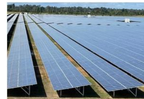
SchneiTec社にて設置済みの太陽光発電システム
