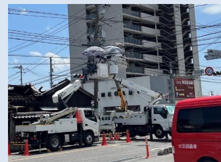
電気通信設備の24時間365日保守業務 (岡山県)
