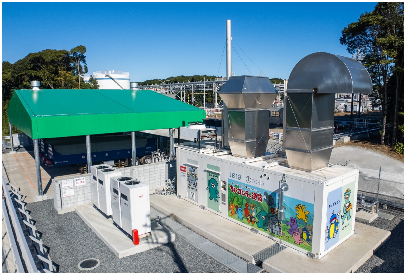
水素発電設備(袖ヶ浦火力発電所(千葉県袖ヶ浦市)構内)
