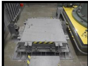
取水槽閉止板
