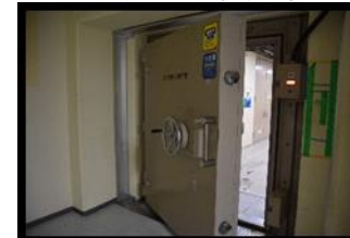
水密扉等の浸水防護対策
