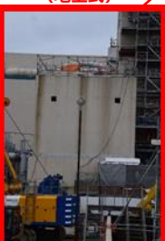
フィルタバント設備 (地上式)
