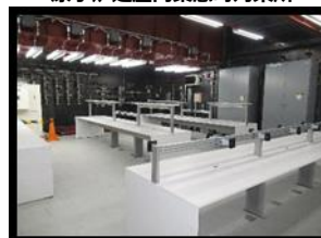
原子炉建屋内緊急時対策所
