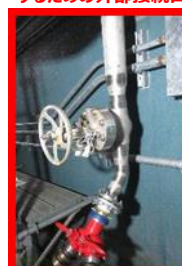
使用済燃料プールに注水するための外部接続口
