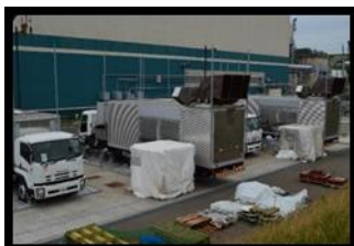
ガスタービン発電機
