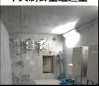
中央制御室退避室
