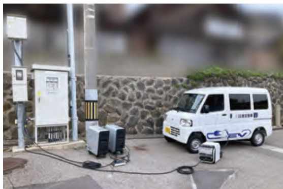
▲ 停電時マンホールポンプ起動支援システム
