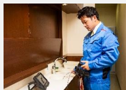
ビデオスコープによる水道管検査
