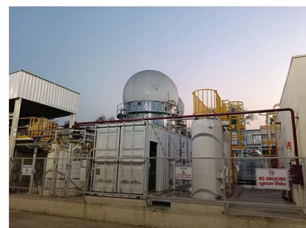
マネサール工場に設置したバイオガスプラント
