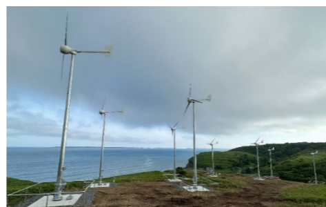
発電量5kw/基(北海道 幌戸)
